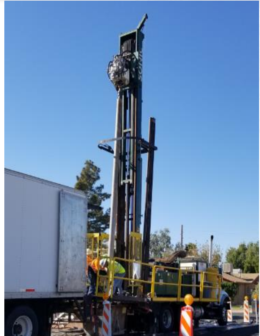
Sonic Drill Rig and Support Truck, Groundwater Monitoring Well Installation / Equipo de perforación sónica y camión de apoyo, instalación de pozos de monitoreo de aguas subterráneas
