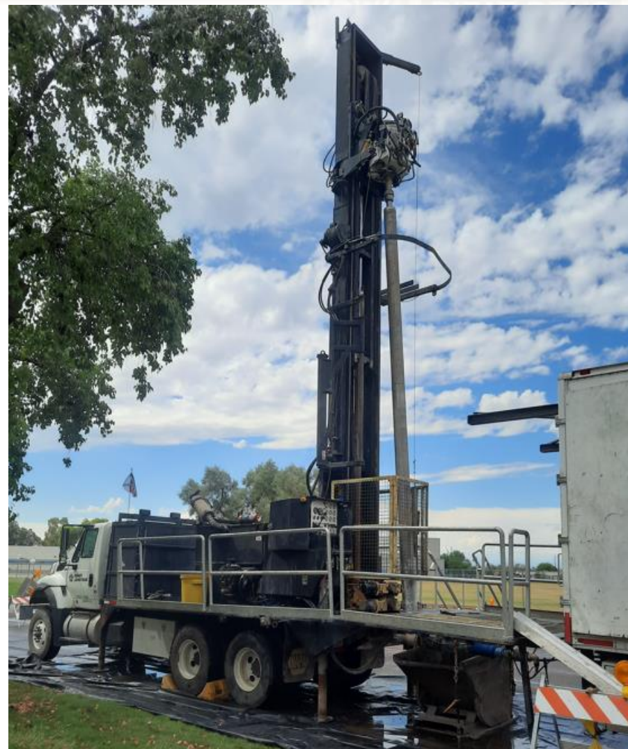
Sonic Drill Rig and Support Truck, Groundwater Monitoring Well Installation / Equipo de perforación sónica y camión de apoyo, instalación de pozos de monitoreo de aguas subterráneas
