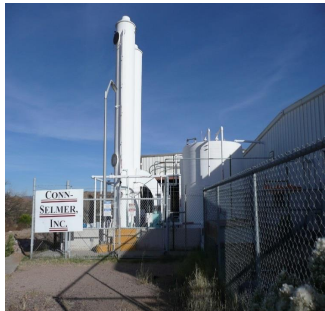
Figura 4 - Sistema de Remediación de Aguas Subterráneas (SRAS); 1310 West Fairway Drive, Nogales, AZ. El SRAS es alimentado mediante el pozo de extracción EW-2 (Figura 2) que bombea entre 50 a 75 galones por minuto (gpm) a un tanque de equalización con una capacidad de contención de aproximadamente 7,000 galones (primer plano a la derecha). El agua contaminada con bajos niveles de solventes orgánicos clorados volátiles y productos de degradación (Tabla 1) es remediada a través de dos extractores de aire instalados en serie (centro izquierda). El agua remediada es transferida a un tanque de retención de 7,500 galones para su análisis antes de su distribución a un embalse de superficie revestido, administrado por la ciudad de Nogales. El SRAS opera dentro de una contención secundaria de 8,150 galones, para capturar cualquier derrame de equipo. (ADEQ, 11/2008)
